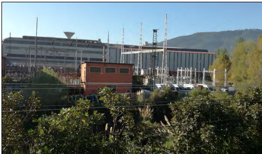
Centro de transformación y depuradora en el AIS-Las Canteras
