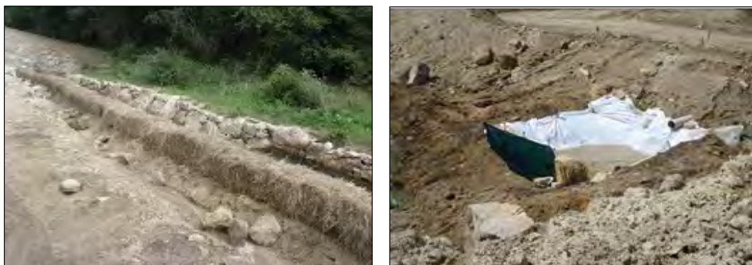
Ejemplos de barreras de retención de sedimentos a partir de pacas de paja y balsa de decantación
